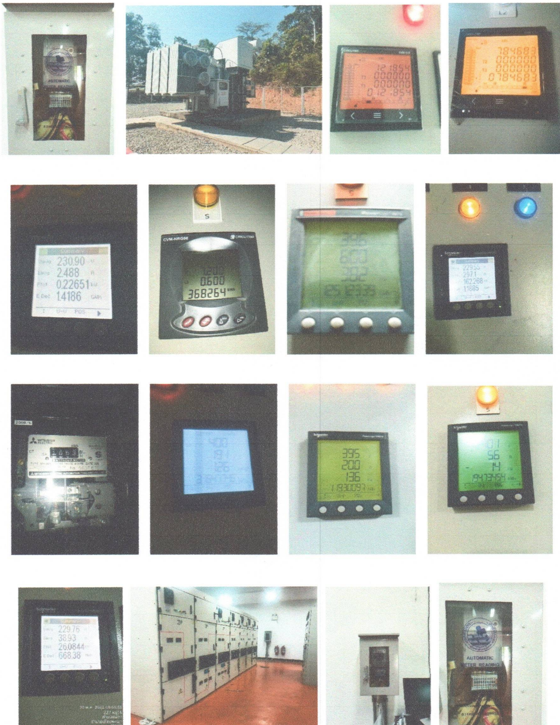
รูปที่ 15 มิเตอร์ไฟฟ้า
