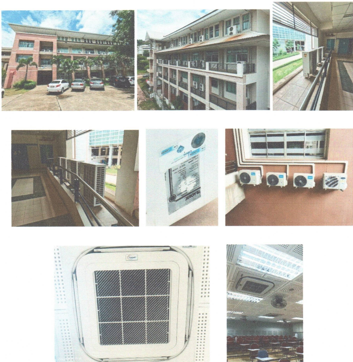
รูปที่ 1 เครื่องปรับอากาศ อาคารเรียนรวม CE
